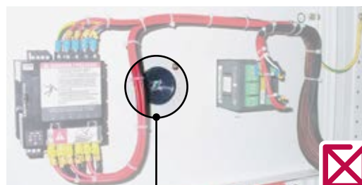
Kabely jsou vedeny příliš blízko otočné rukojeti.
