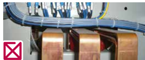
Kabely jsou vedeny příliš blízko přípojnice.
